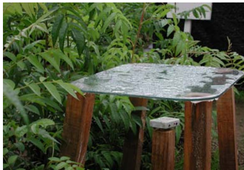
사진 8. 간이 온습도 측정기 설치 모습
